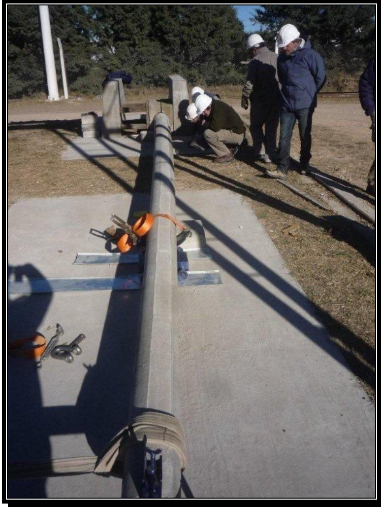
Poste descargado y revisión de fisuras.
